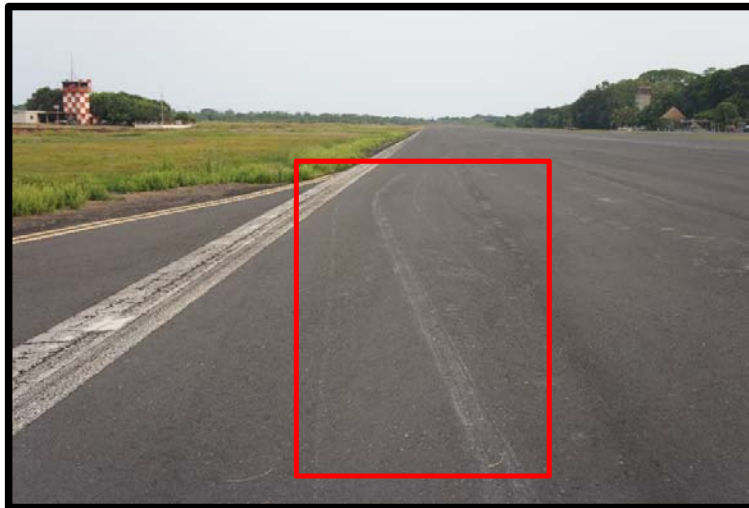
Fotografía No. 10 Vista de la pista marcada por el deslizamiento de la aeronave.
